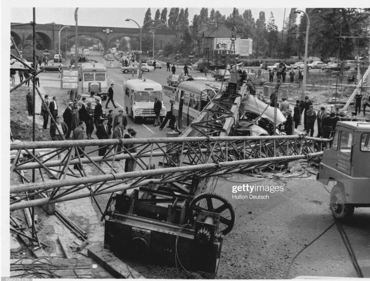
1964년 6월 런던 교외 헨던 고가 공사 중 크레인 붕괴(the Brent Cross Crane Failure) 관광버스를 덮쳐 7명의 승객 사망
